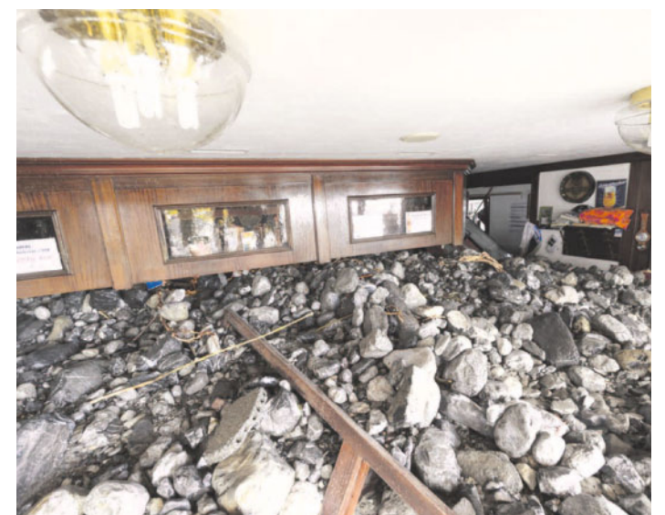
Aufgefüllt. Der Schutt reicht in diesem Restaurant fast bis an die Decke.
