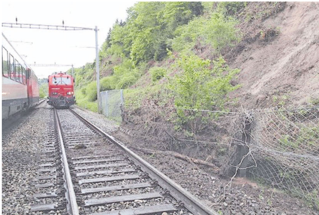
Verkehrsunterbruch. Ein Erdrutsch verschüttete die SBB-Bahnlinie bei Flamatt. FOTO SBB/KEYSTONE
